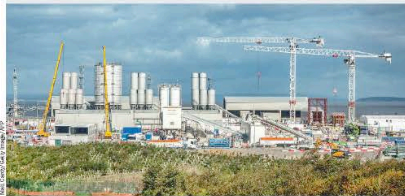
Construction de la centrale d'Hinkley Point, dans le Somerset, en Angleterre. EDF a annoncé des surcoûts de 1,7 milliard d'euros et un risque de retard sur le calendrier initial fixé à 2025.
